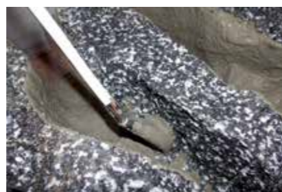
Für die Arbeiten an schwer zugänglichen Stellen eignet sich ein abgewinkelter Malerpinsel
